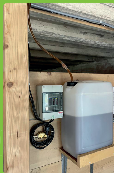
Dosieranlage zur Vernebelung im Stall
